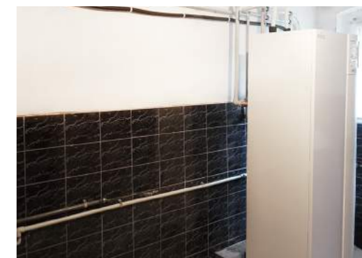
Po modernizacji kotłowni
